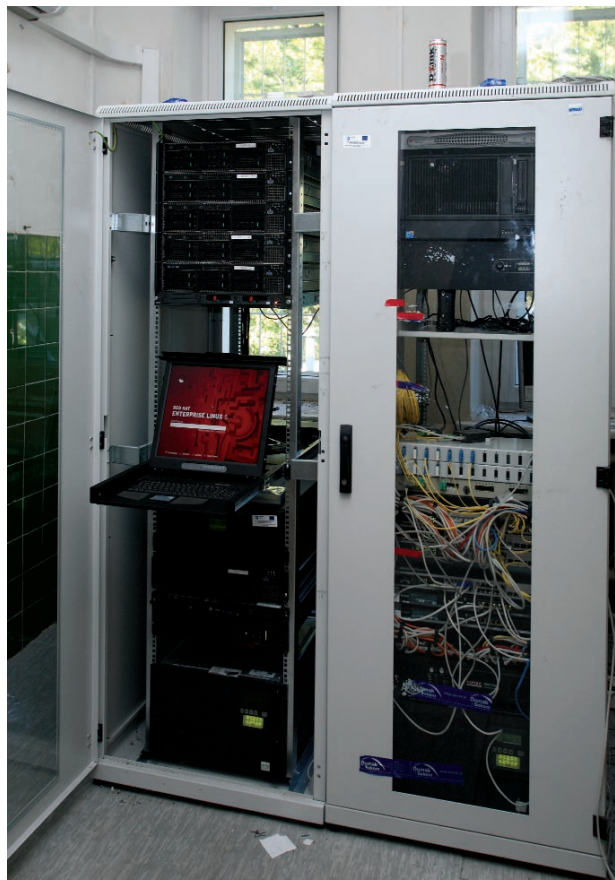
Serwerownia w Szpitalu Wolskim w Warszawie
